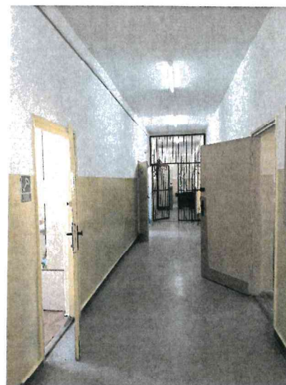
Fot. 8. Posadzka na korytarzu
