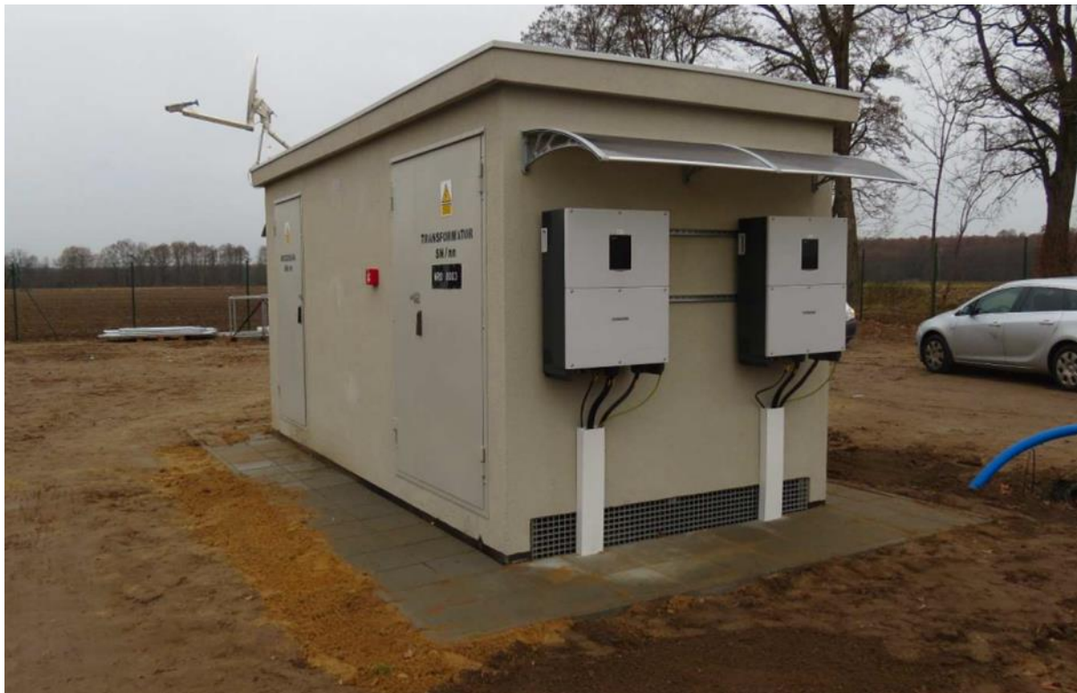
Rysunek 10. Przykładowa stacja transformatorowa z zainstalowanymi inwerterami
