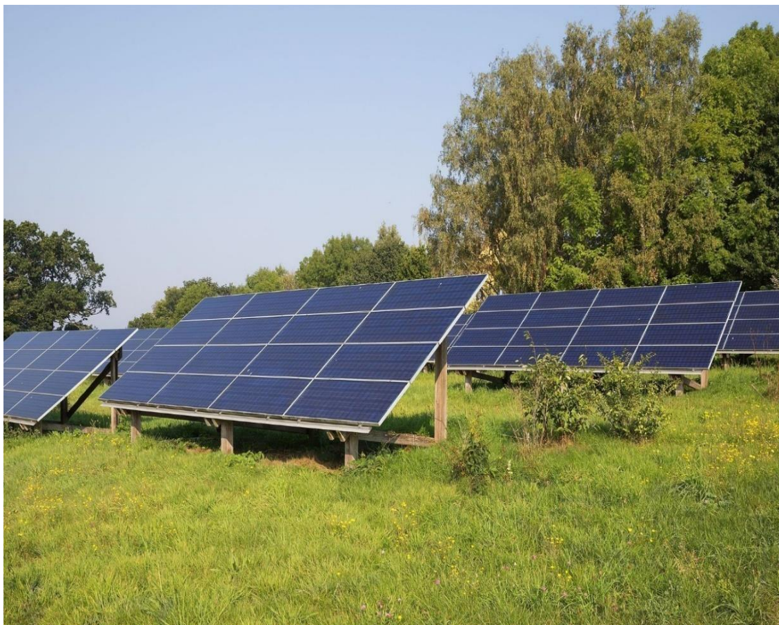
Fot. 37. Przykładowe zagospodarowanie terenu pod oraz pomiędzy rzędami stołów fotowoltaicznych.
