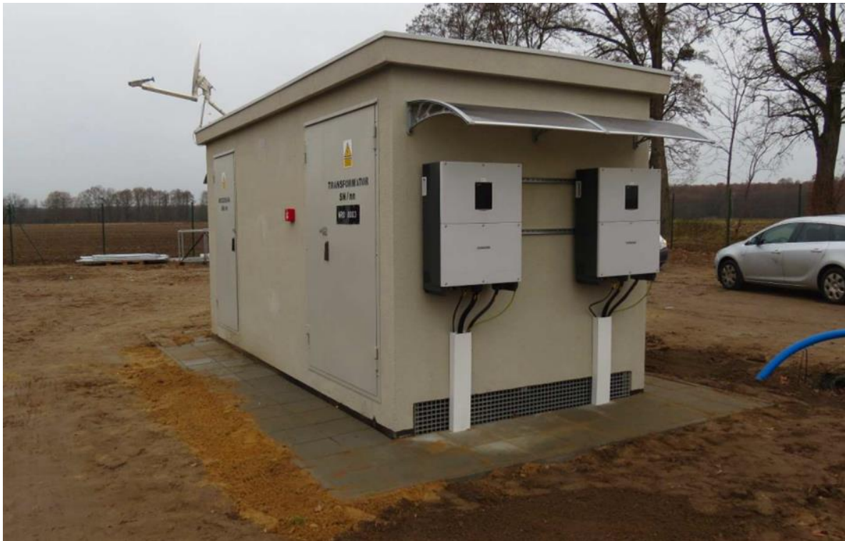
Rysunek 9. Przykładowa stacja transformatorowa z zainstalowanymi inwerterami
