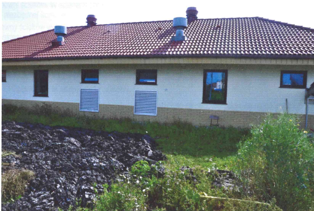
Fot. 3. Ściana zachodnia budynku technicznego, z czepnikami ze stacji dmuchaw. Przed budynkiem widoczne składowisko osadu
